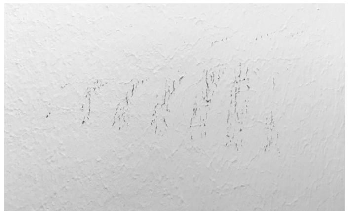
Abb. 1 (oben) // Beispiel für Scuff auf einer handelsüblichen Wandfarbe (1).
